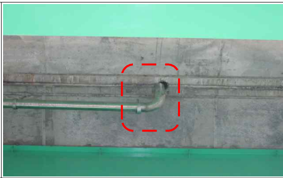
상행선 S6 배수관 연결부 어긋남 및 연결고리 탈락
