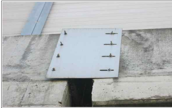
상행선 A1측 차수관 앵커볼트 탈락
