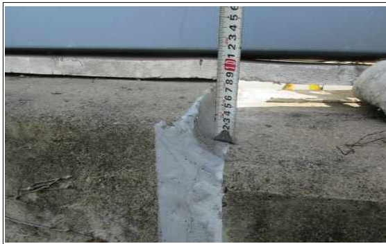
상행선 A2측 방호벽 단차 발생
