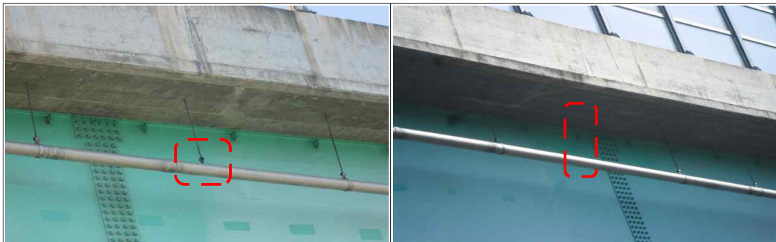
상행선 S4 배수관 연결고리 탈락
