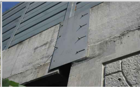
하행선 A1측 차수관 앵커볼트 탈락
