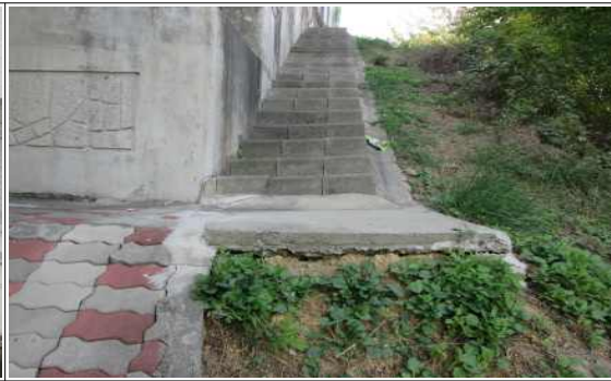
상행선 A2측 점검계단 하부 토사 유실 및 공동 발생
