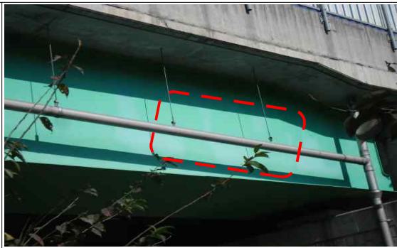
하행선 S1배수관 연결고리 탈락
