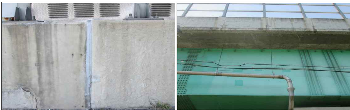
하행선 A1측 접속도로 구간 방호벽 단차
