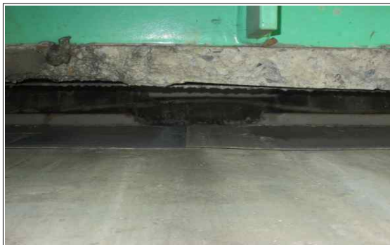
상행선 A2 신축이음 본체 하부 고무씰재 파손
