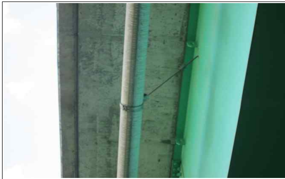
상행선 S7 배수관 연결재 탈락
