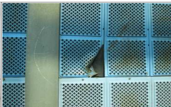
상행선 S3 방음벽 판넬 파손
