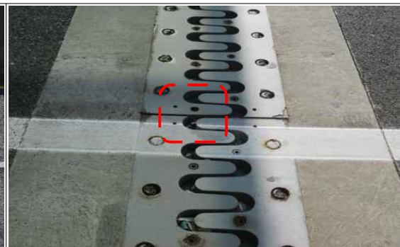
상행선 A2 신축이음 본체 상부 고정볼트 탈락
