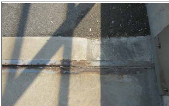
하행선 A2 신축이음 본체 녹발생 및 이물질 퇴적
