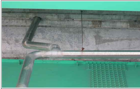
상행선 S4 배수관 연결고리 탈락
