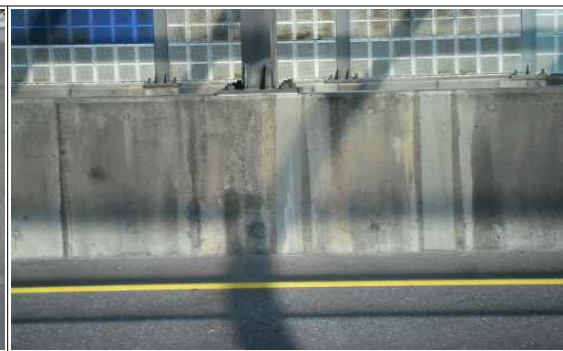
하행선 S3 중분대 보수부 재균열 및 백태
