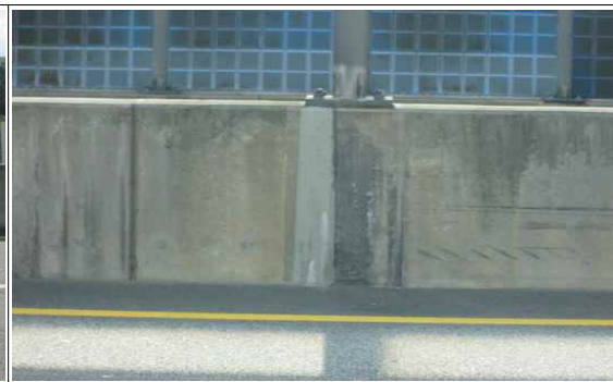
상행선 S3 중분대 균열부 백태
