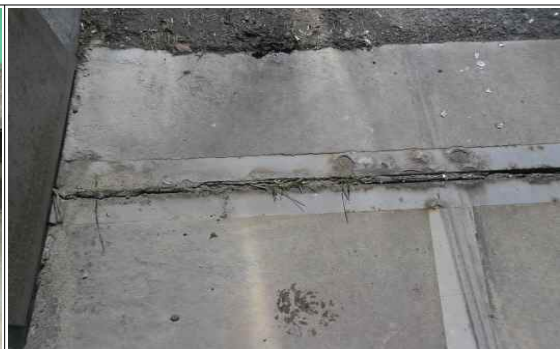
상행선 A2 신축이음 본체 녹발생 및 이물질 퇴적
