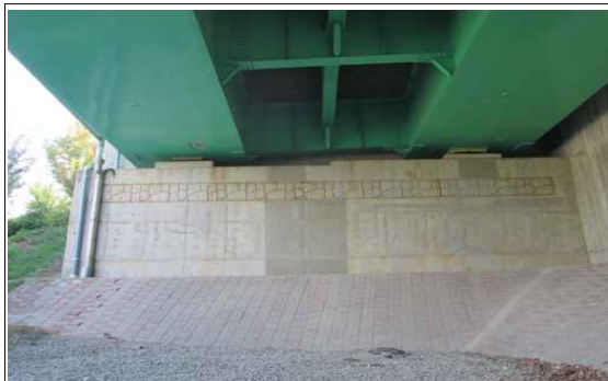
상행선 A1 벽체 누수흔적 및 백태 보수 현황
