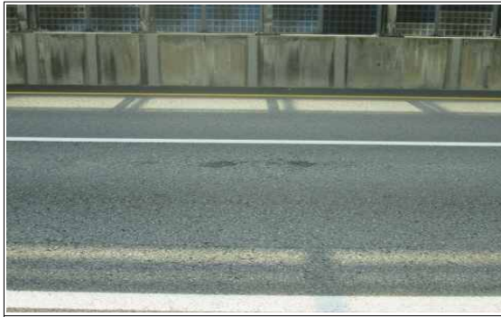
상행선 S4 교면포장 패임
