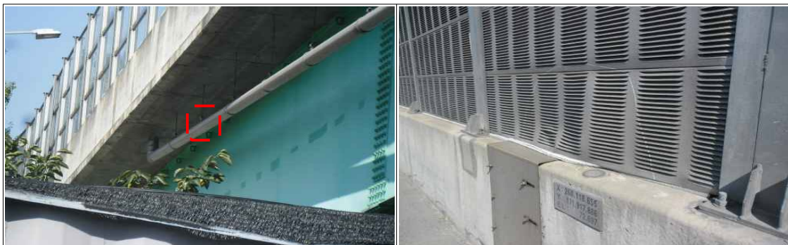
하행선 S5 배수관 연결고리 탈락
