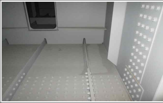
상행선 S7 G1 주형내부 우수유입 및 누수흔적
