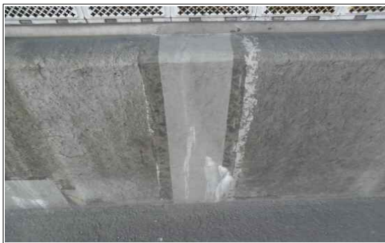
하행선 S2 방호벽 균열부 백태
