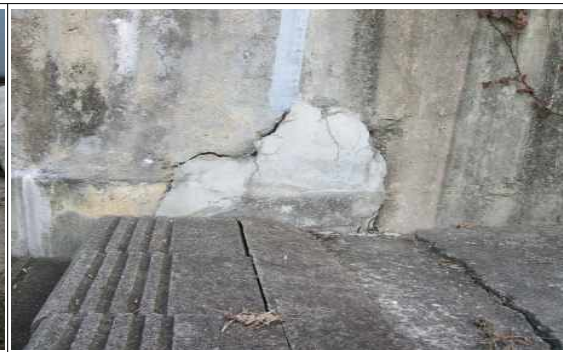
상행선 A2 방호벽 배면 콘크리트 들뜸 및 파손
