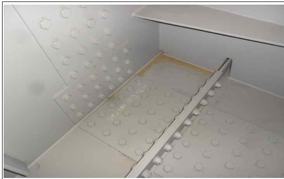
하행선 S7 G1 주형내부 우수유입 및 누수흔적
