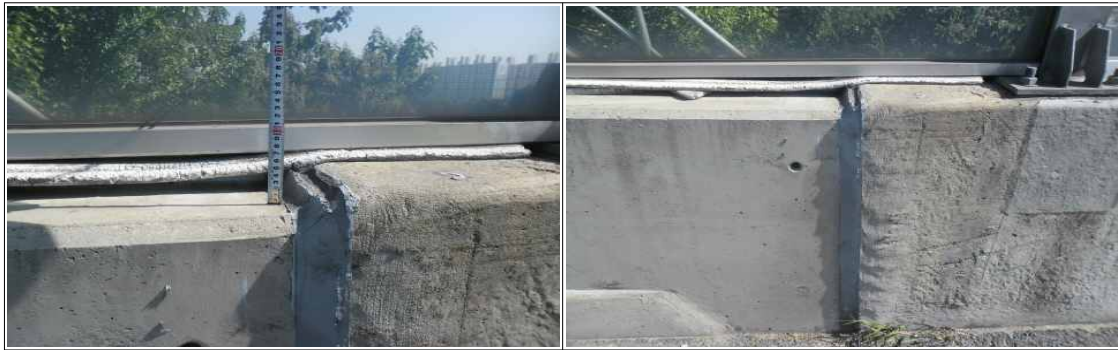
상행선 A2측 접속도로 구간 방호벽 단차 (4.0cm) 및 실란트 보수
