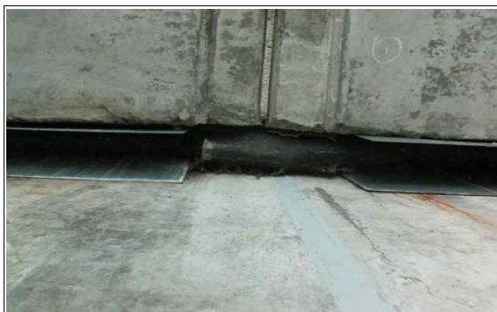
상행선 A2 신축이음 본체 하부 고무배수관 연결부 불량
