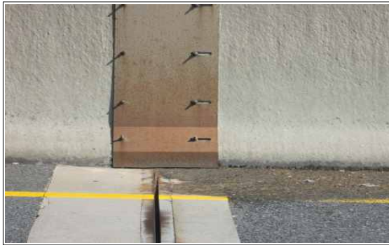
하행선 S5 교면포장 물고임 (체수)
