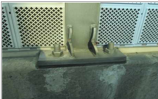
상행선 S5 방음벽 지주대 RIB 변형
