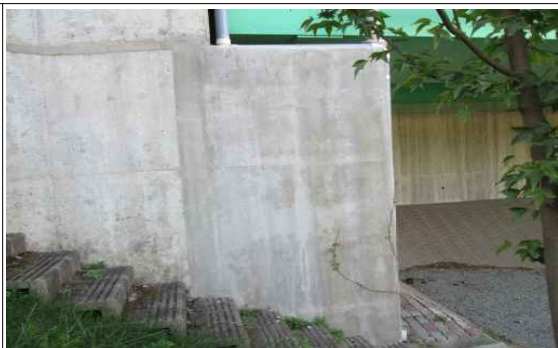
상행선 A1 벽체 누수흔적 보수 현황
