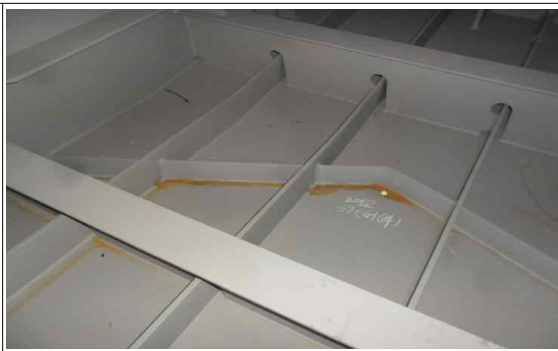
하행선 S7 G1 주형내부 우수유입 및 누수흔적
