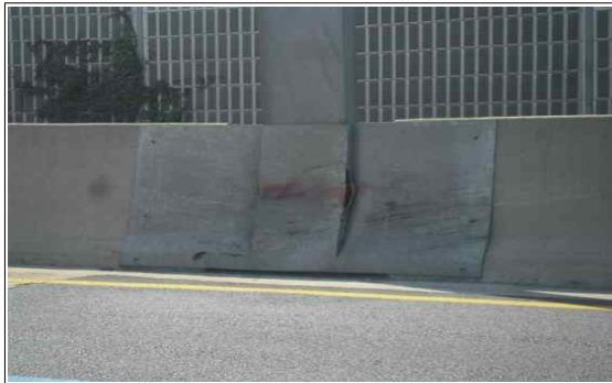
상행선 A1측 도로안내 표지판 차량충돌에 의한 기둥덜개 파손
